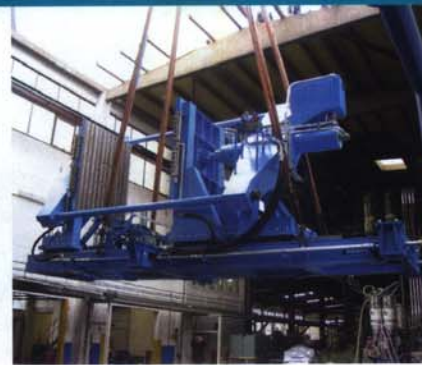
■ Die neue Großblasanlage zur Kunststoffbehälterproduktion beim „Einflug“ in die Halle.
