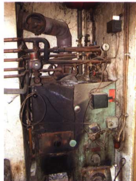
■ Dieser Kesseloldie hat bei der Handwerkermarken-Aktion das Rennen gemacht. Das „alte Möhrchen“ wurde inzwischen gegen einen modernen Holzvergaserkessel ausgetauscht.
