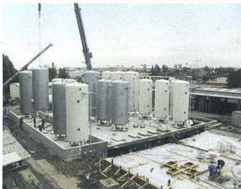
Großprojekt Stahlbehälter Foto: Dehoust GmbH
